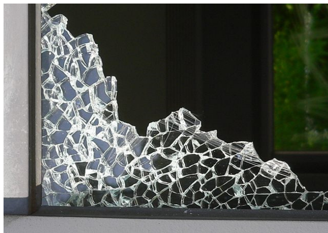
Рис. 3. «Пример разрушения закаленного стекла»
