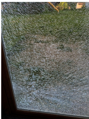
Рис. 1. «Пример разрушения ламинированного стекла»
